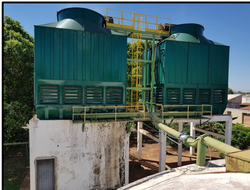
Sistemas isolados de poços profundos Poço Ipanema – 2018
