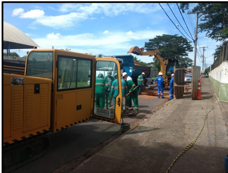
Obras em vias públicas Método Não Destrutivo – Escavação e posicionamento dos tubos sob a superfície
