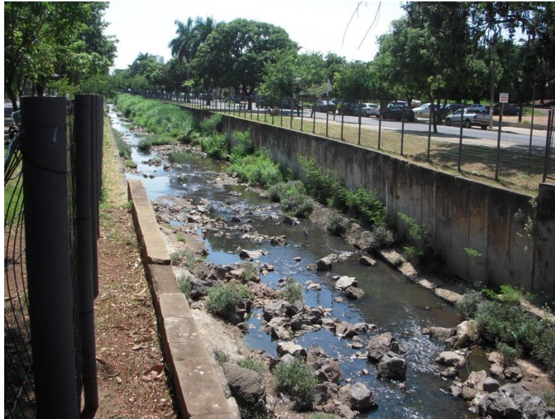
Canal do Córrego Machadinho – Av. Joaquim Pompeu de Toledo Necessidade de limpeza de vegetação e escombros de rocha
