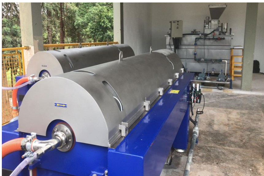
Estação de Tratamento de Esgotos Bagaçu Moderno processo de desidratação do lodo – 2018
