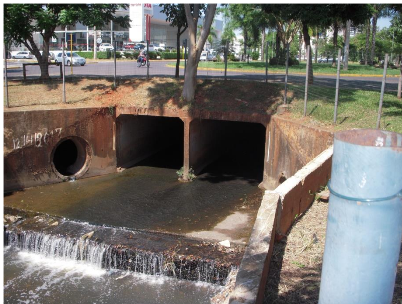
Córrego Machadinho – Trecho em galeria de duas células Necessita reforço de mais uma célula
